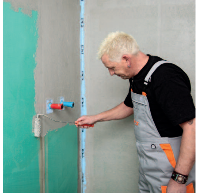
4. Erste Schutzschicht mit PCI Lastogum (grau) unverdünnt satt und oberflächendicht auf den Untergrundaufträgen.
