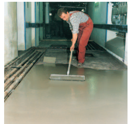
Auf der klebefreien, ausgehärteten Grundierung ausgegossenes und verteiltes PCI Zemtec 1K während des Einbaus mit einer Stachelwalze egalisieren und entlüften.
