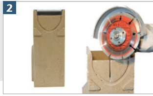
2 Zum Anschließen des Rinnenkörpers die Vorformung am Einlaufkasten mittels Winkelschleifer mit Diamantscheibe mittig einschneiden ...
