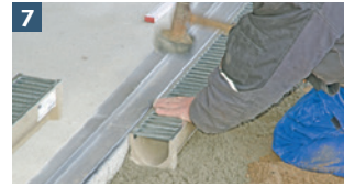
7 Ansetzen des Rinnenkörpers an den Einlaufkasten. Ausrichten des Rinnenstrangs. Die 2 cm Garagenschwelle ist so ausgeführt, dass das Tor zwischen Schelle und Rinne schließt
