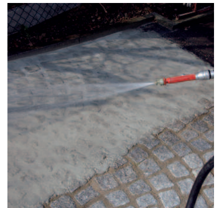
Um beim Reinigen der Pflastersteine ein Ausspülen der Fugen zu vermeiden, ist der Wasserstrahl nahezu horizontal zur Oberfläche zu halten.
